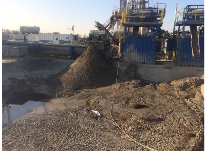
Şekil 5 GEOS Enerji Atık Yönetimi Uygulaması Çamur Havuzu
